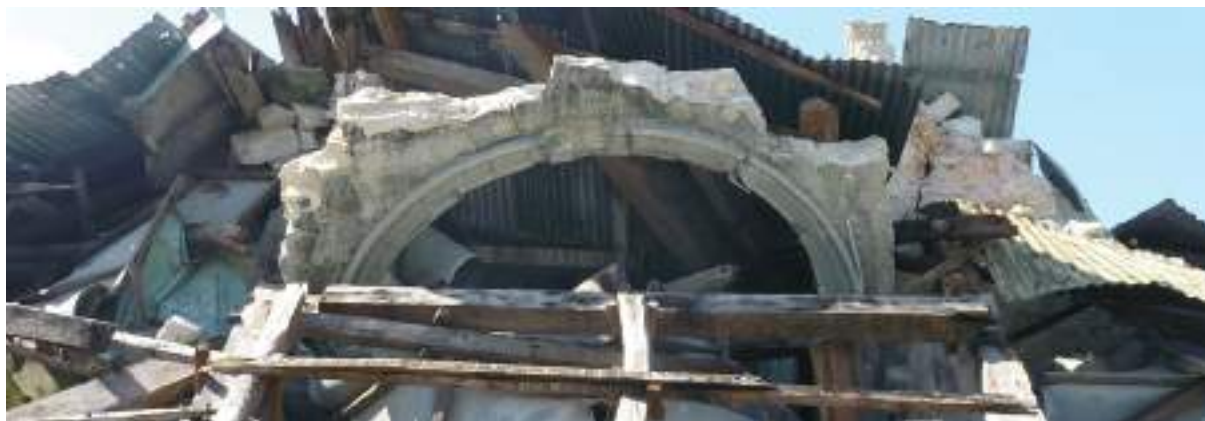
Restos de la Iglesia de Loom, totalmente destruida como consecuencia del terremoto del 15 de octubre de 2013 que asoló la isla de Bohol (Filipinas). Foto: UEGR
