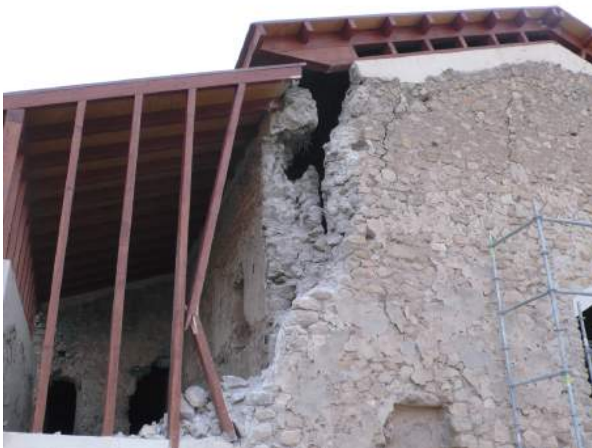
Efectos del terremoto de Lorca en la Ermita de San Clemente. Mayo 2011. Foto: UEGR
